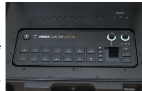
(Imagen 14) Rodecaster Video correctamente instalado
