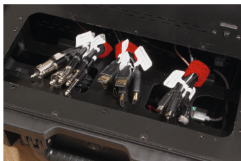
(Immagine 12) Fascio di cavi allo stato di consegna
